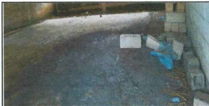
Foto 6: Se observa la necesidad de la reparacion del piso de torta de concreto.
