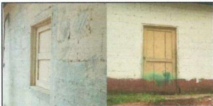
Foto 5: Se observa la necesidad de la sustitucion de ventana de madera por metal mas vidrio y sustitucion de puerta.
